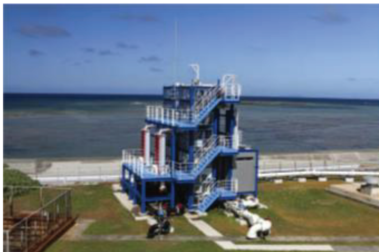
图 7 日本冲绳 100 kW OTEC 示范电站
